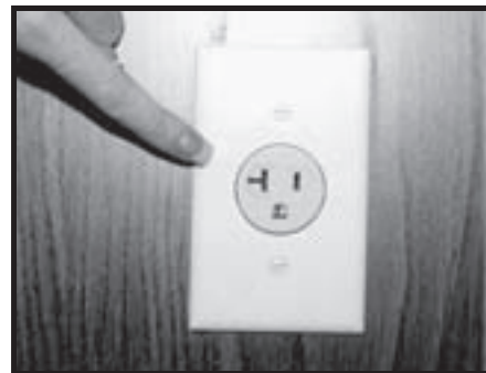
NEMA 5-20 20 amp Receptacle
